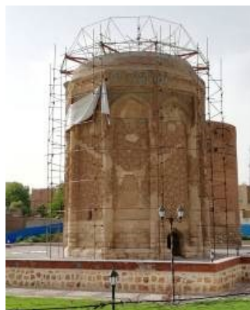
تصویر ۱. فریم گذاری و اسکلت بندی برای اجرای گنبد کیبود، مراغه (منبع نگارندگان)
